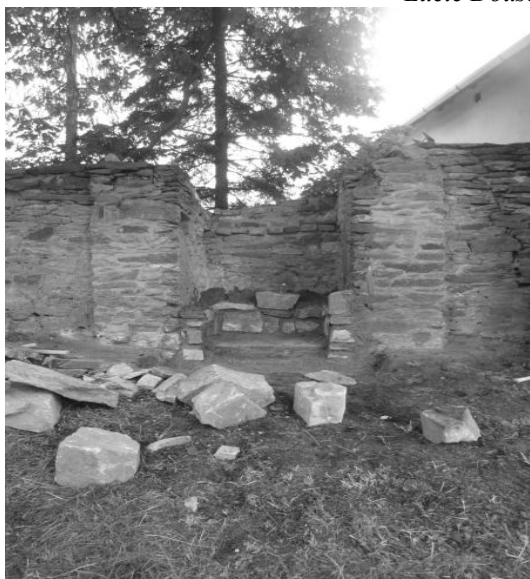
Rozvaliny původní kapličky před rekonstrukcí
